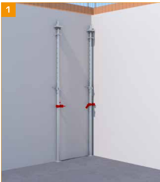
- Mettre en place et brider les 2 premiers étais. → Ici, grâce à la bride HorizontalAL pour étais acier.
