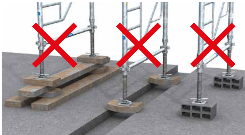
Empilhamento excessivo de calços
