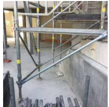
Desnivelamento na base
