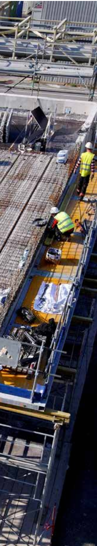
Obra: fábrica de transformação Comurhex II Cliente: GTM Sud, SM Entreprise Local: Narbona
