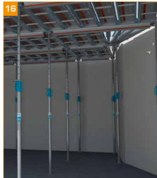
- Afinar o nivelamento por meio de um nível de laser, suporte a suporte. - Uma bitola suspensa da cofragem permite que um único homem efetue a regulação com o nível de laser. - Nesta etapa, efetuar uma verificação final do bloqueio dos cabeços.
