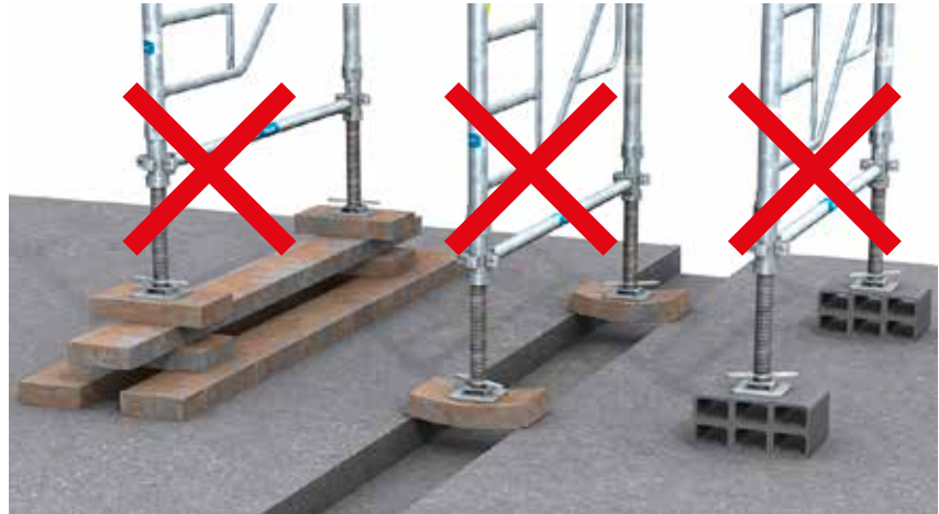
Empilage excessif de cales
