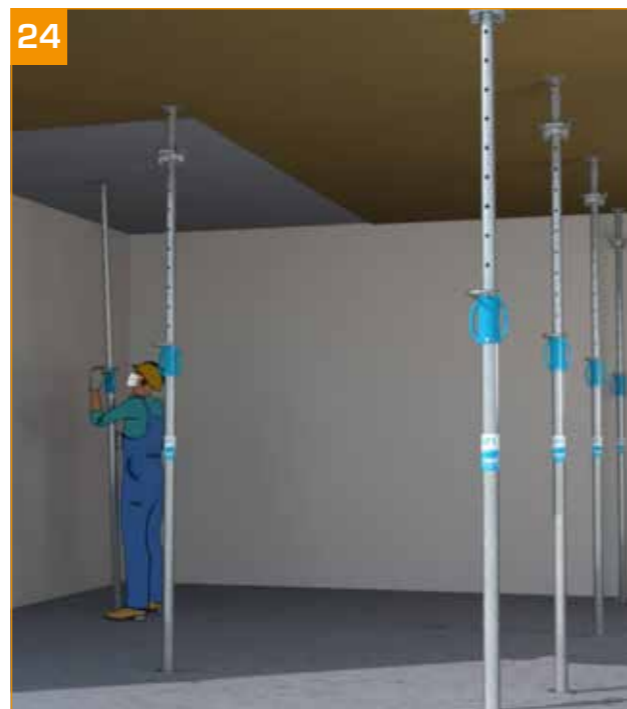
24 - Montagem da primeira escora de secagem, respeitando a regra de uma escora por cada 5 m 2 (caso geral).
